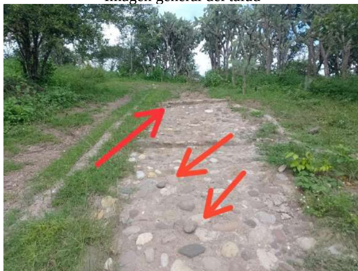
Imagen mostrando los desprendimientos
