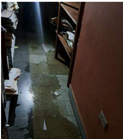
Filtración de agua en el depósito.
