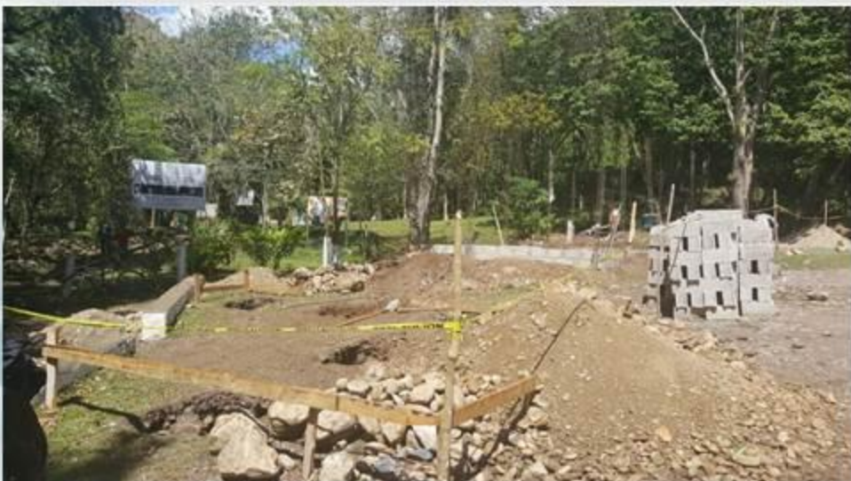
Avances de la construcción en el acceso al Parque Eco Arqueológico Cuevas de Talgua
