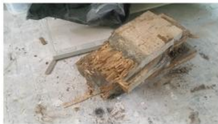
Vigas existentes de losa totalmente podridas.
